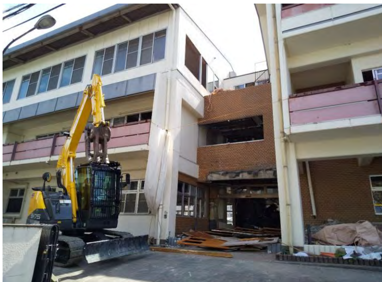
まずは、建物内の残置物の撤去です。風呂設備・厨房内設備や、空調機、不要物などを、どんどん出していきます。そして、玄関が壊されている様子が写真でわかります。
