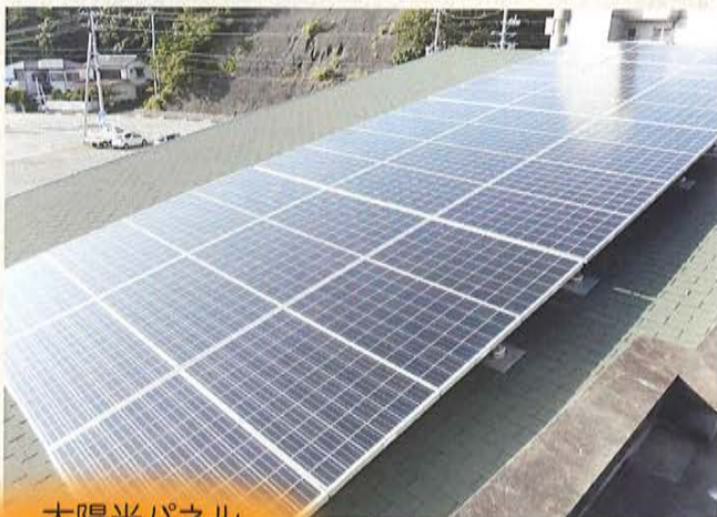
太陽光パネル
