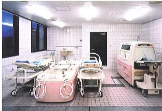
特殊浴室 順送式入浴装置(写真内左の機械)とシャワー入浴装置
