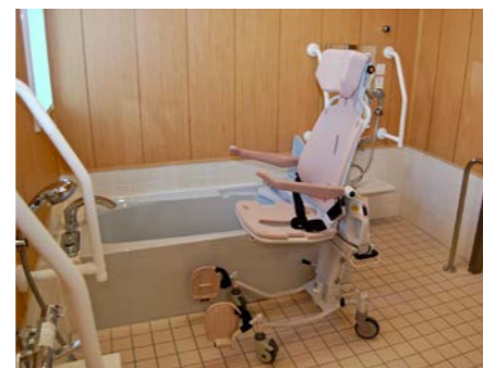
浴室一例 入浴リフト付シャワーキャリー完備。
