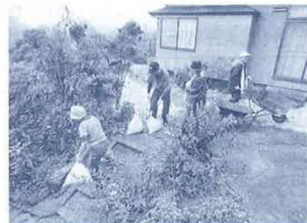
崖くずれの危険がある民家に、土のうを作って設置しました(午後)
